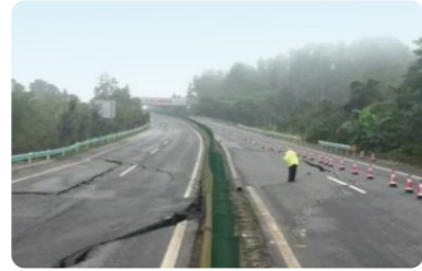
路基沉降监测
